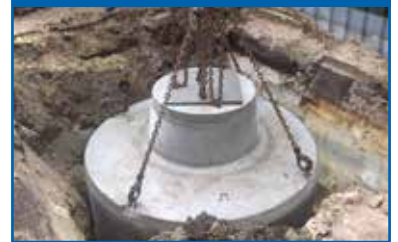
Regenwatersysteem woonhuis Epen
